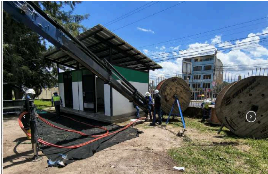
Imagen 34. Proyecto "Repotenciación del sistema eléctrico de la Universidad de las Fuerzas Armadas - ESPE"
